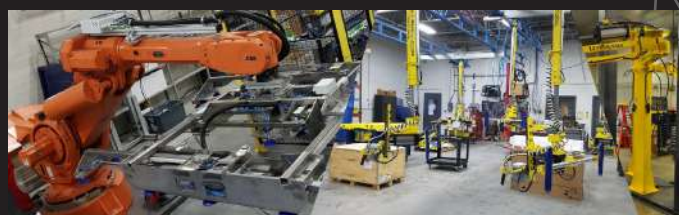
Urządzenia transportu bliskiego
